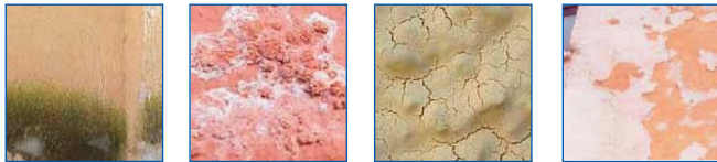
Algenbildung Salzausblühungen Rissbildung Abblätterung
